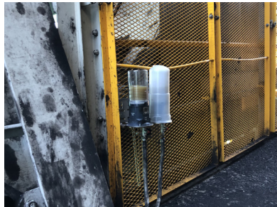
Branche: Kies- und Schotterwerke Anwendung: Förderband
